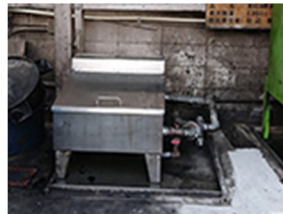
地下廃油タンク
